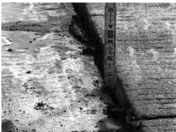
图 1-6 路面不均匀沉降错台
