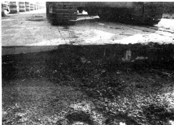
图 1-8 维修中展现出的路面结构
