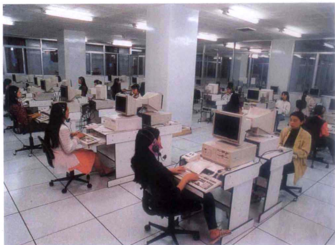
无线寻呼机房
