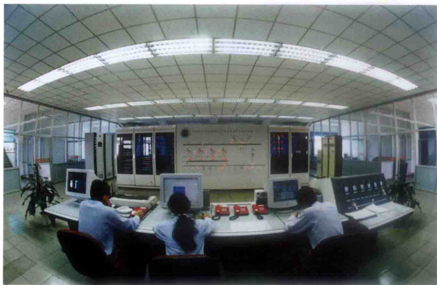
云南铝业股份公 司 220kV 变电站 主控室
