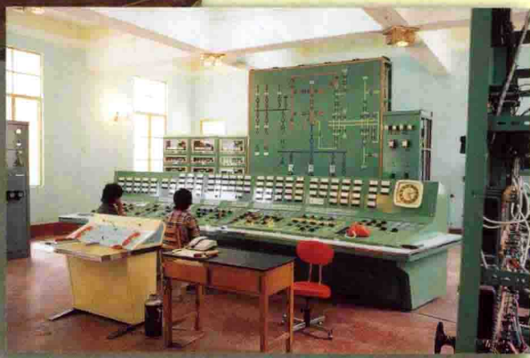
大响水电站中控室
