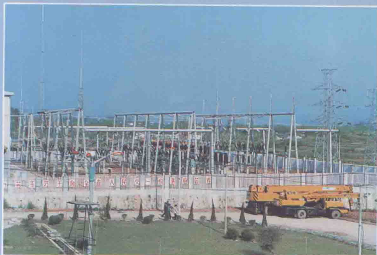
梅縣發電廠輸變電設備
