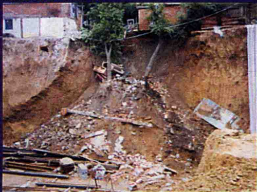
某基坑土方边坡失稳
