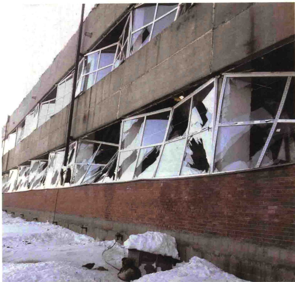
图 1-2 爆炸导致房屋的玻璃受损
