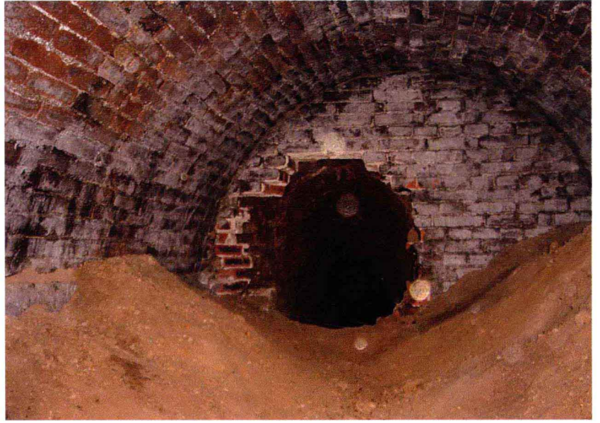
2. 一号墓封土内防空库房墙壁上的盗洞
