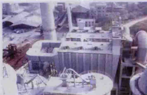
粉尘处理工程实例
