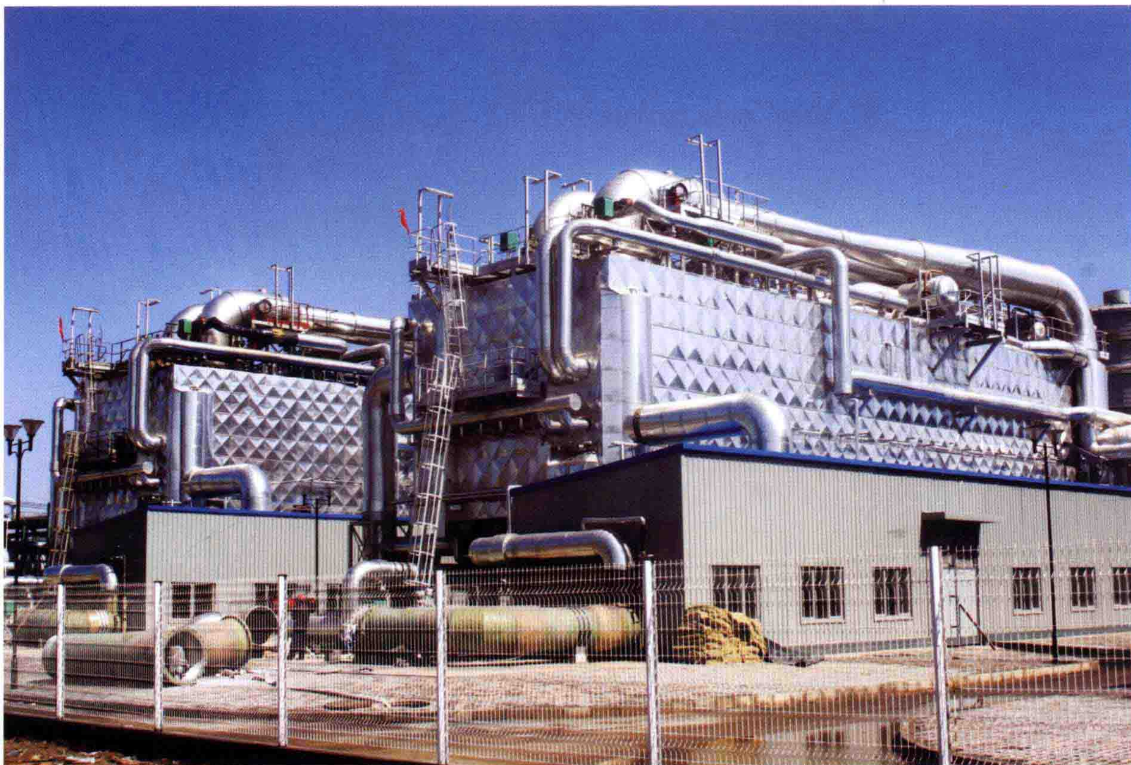
首钢国际工程公司设计的京唐钢铁厂 4 \times 1.25 万 \text{m}^3/\text{d} 低温多效海水淡化装置
