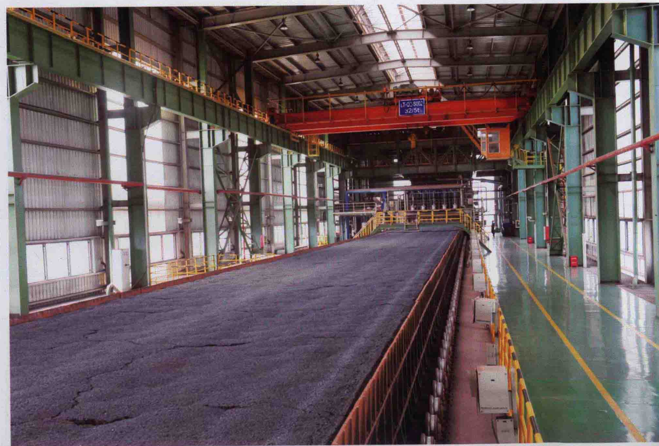
首钢国际工程公司设计的京唐钢铁厂550m 2 烧结机
