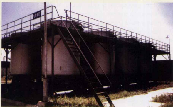
浙江晴纶厂污水站
