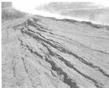
b) 膨胀土路堤边坡滑塌
