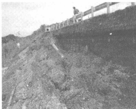
a) 膨胀土路堤边坡滑塌
