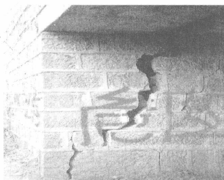
f) 膨胀土引起的锥坡开裂
