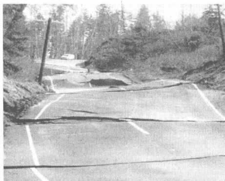
c) 膨胀土引起路面变形
