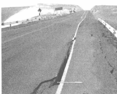
d) 膨胀土引起路面纵向开裂
