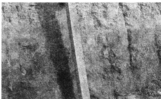
图 1-2 向下挖掘墙壁散发水分状
