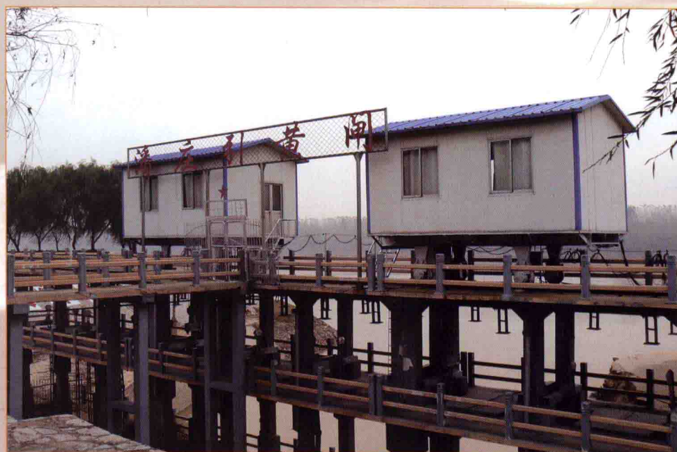
山东潘庄引黄济津线路潘庄渠首闸
