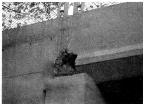
图 1-15 伸缩缝处破损
