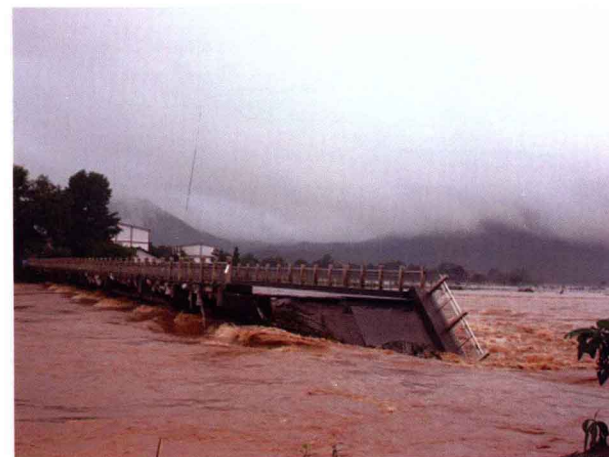
2010年6月19日，206国道鹰潭龙虎山鱼塘大桥被洪水冲断（江西省鹰潭市气象局提供）
