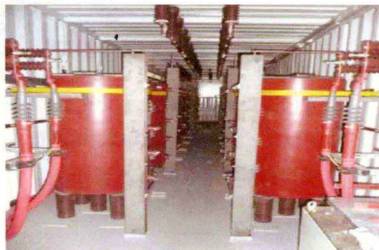
图2 风电移动检测平台集控车内部构造
