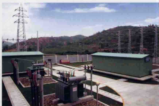
全市设备最先进的变电站——西河35千伏变电站
