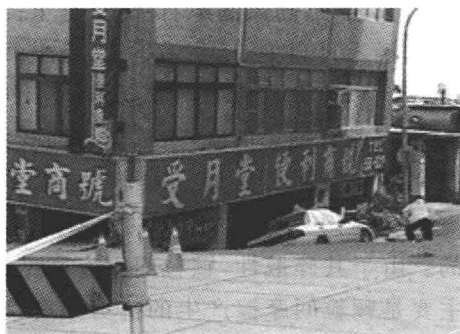
图 3 台湾高雄地铁施工造成的楼房沉陷
