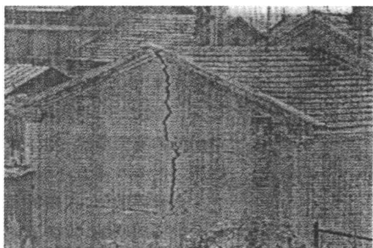
图 4 我国东北地区由于冻胀造成的房屋开裂
