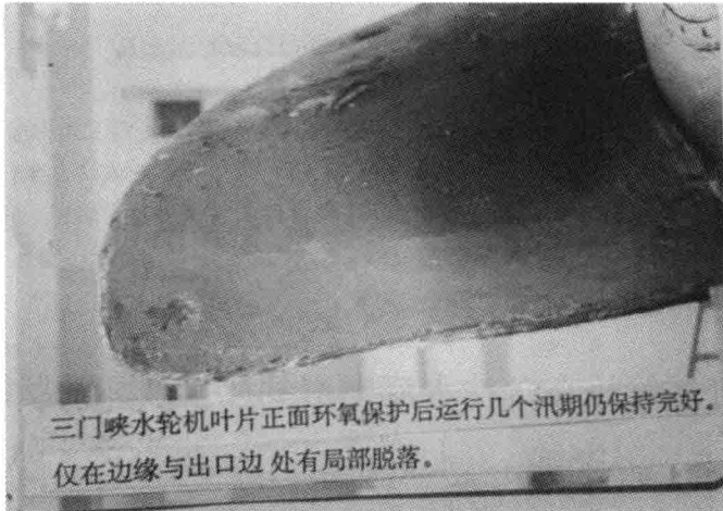
图 1 叶片正面的破坏
