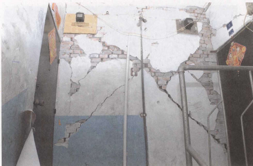
图 1-11 承重墙体出现交叉斜裂缝
