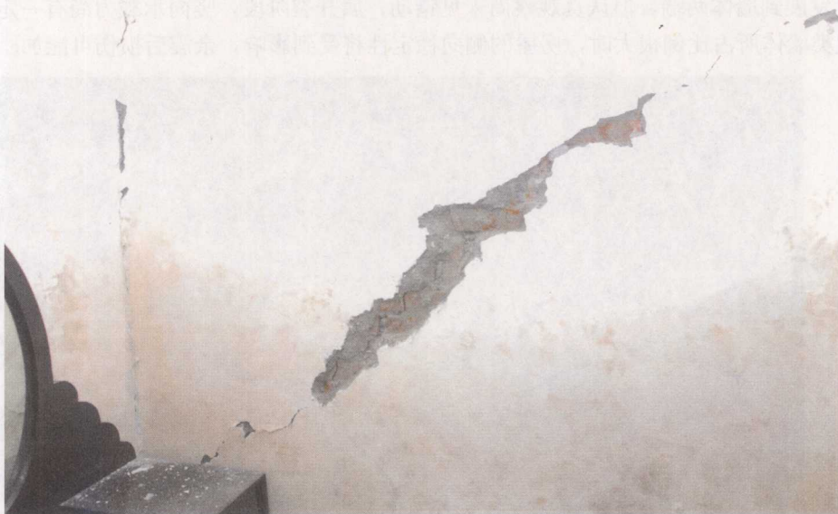
图 1-7 墙体上由剪力引起的主拉应力斜裂缝破坏形态
