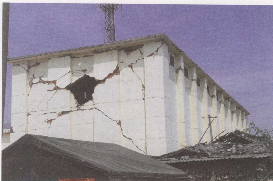
图 1-12 厂房山墙的超大交叉斜裂缝
