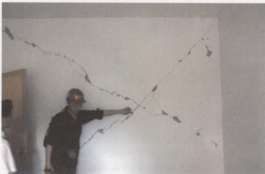
图 1-9 承重墙体出现交叉斜裂缝
