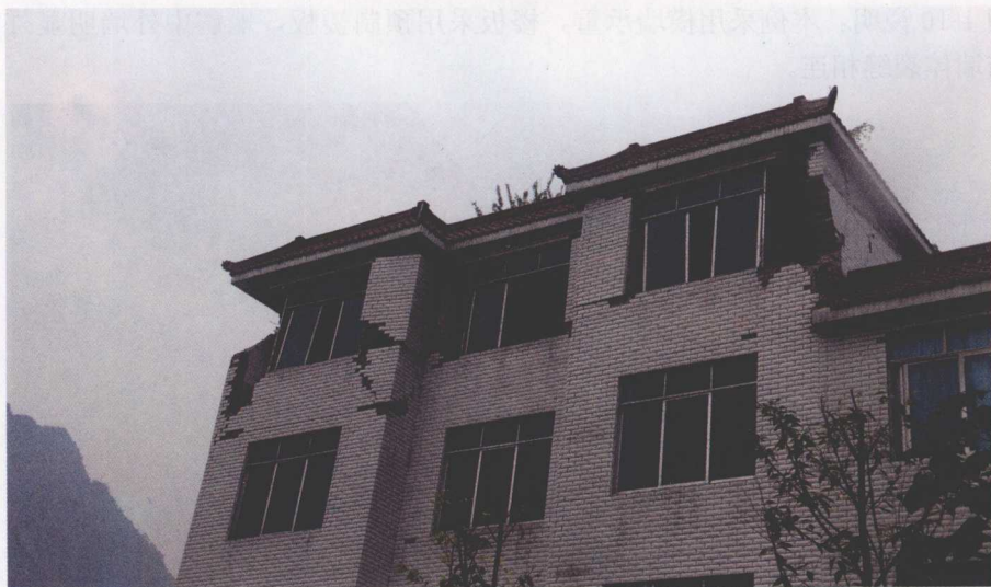
图 1-15 小墙肢弯剪斜裂缝破坏形态
