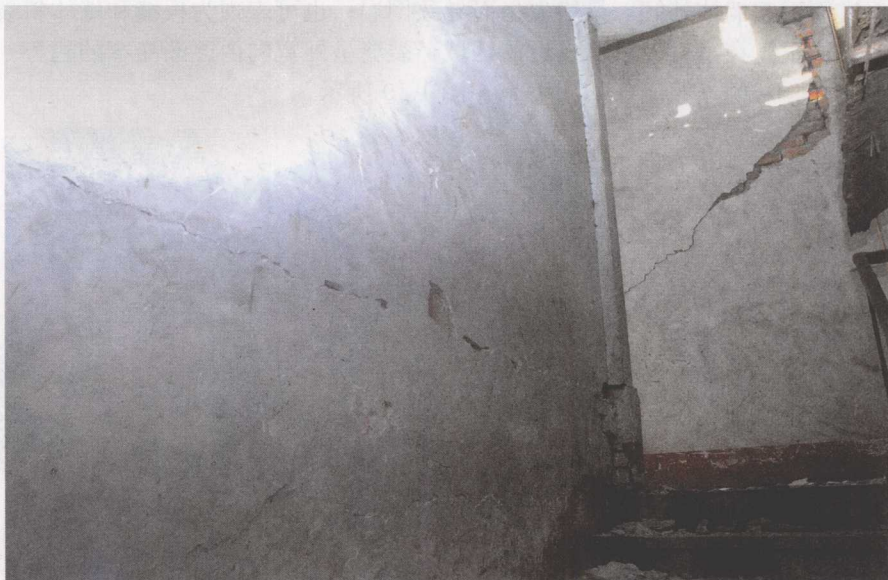
图 1-14 承重墙体上的水平剪切裂缝形态
