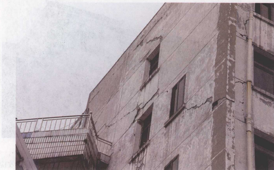
图 1-17 房屋部分发生弯剪倾覆破坏裂缝
