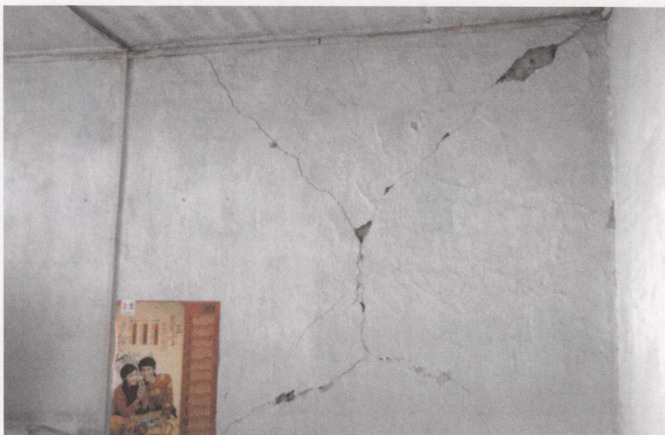
图 1-10 承重墙体出现交叉斜裂缝
