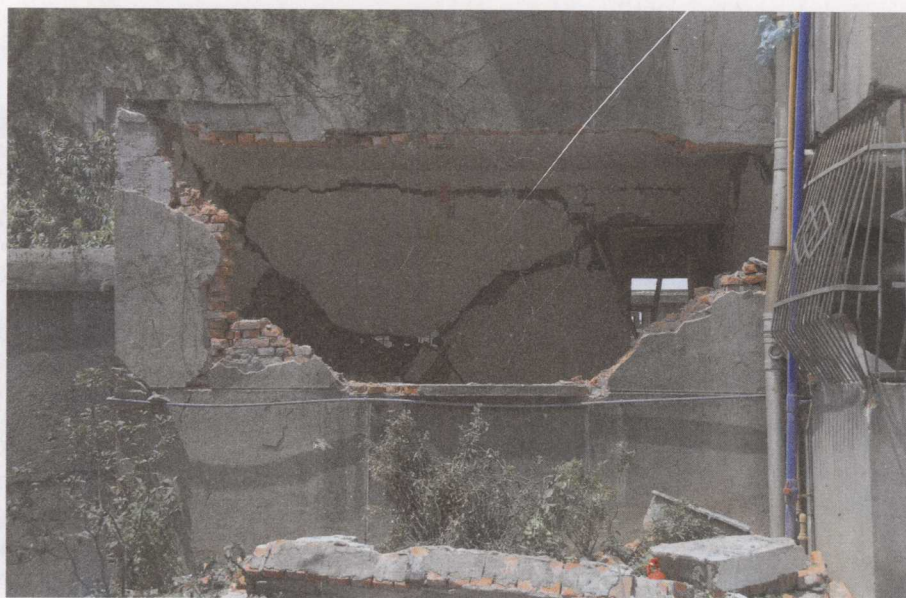
图 1-13 承重墙出现交叉斜裂缝
