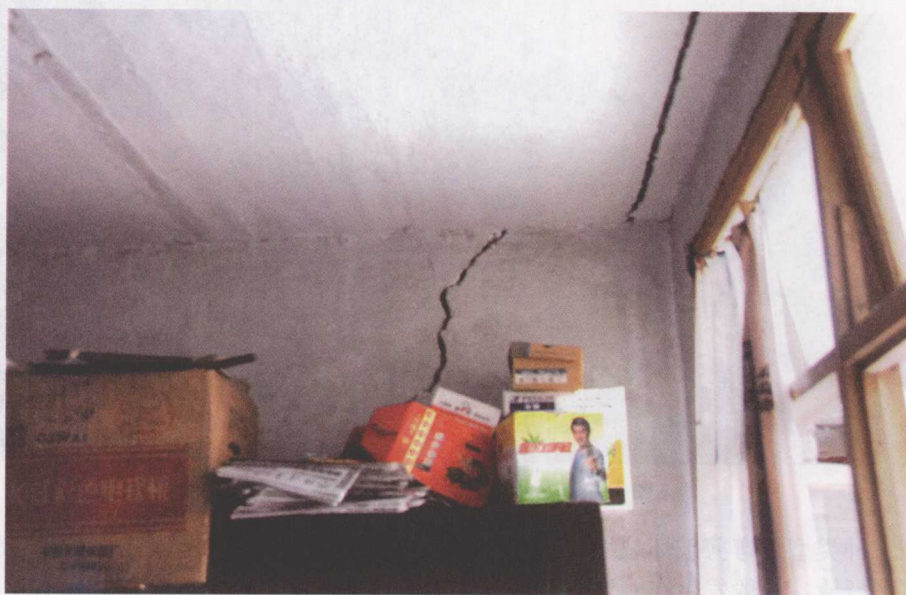
图 1-16 外纵墙向外倾覆产生破坏裂缝
