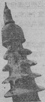
圖 4 由于磁套管受 大气过电压襲击，發 生閃絡所引起損 坏的情况
