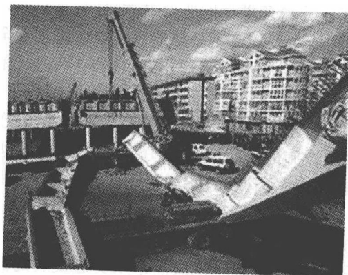
图 1-4 上海江杨北路立交桥施工事故
