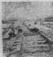
照1-1 K1321+50~K1322+30路堤高2~3m，天然护道宽1~3m，路堤通过旧线取土坑内，竣工后即铺筑，机车通过时，路堤发生坍塌，最大下沉达1.5m。
