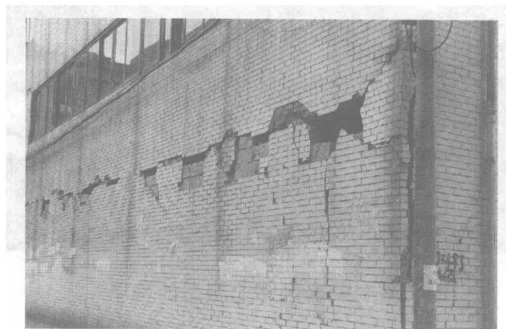
图9 填充墙与梁拉结不当引起的破坏
