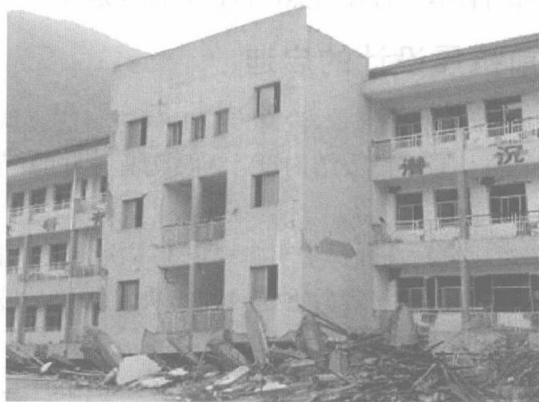
图 13 某建筑物底部垮塌情况
