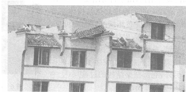
图 10 砖砌女儿墙倒塌
