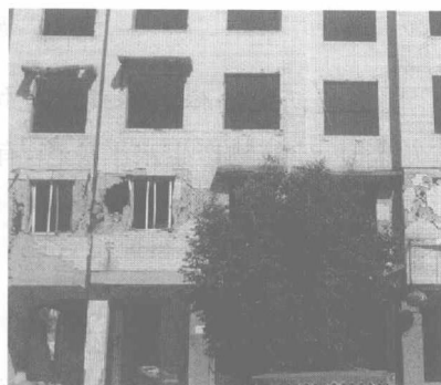
图8 底框结构过渡层破坏
