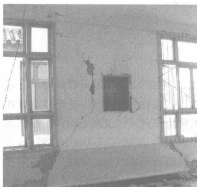
图2 砌体交叉斜裂缝
