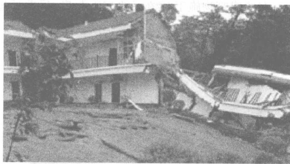
图 11 断裂带上房屋的垮塌
