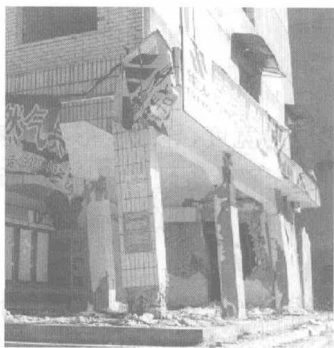
图7 底框结构底层破坏
