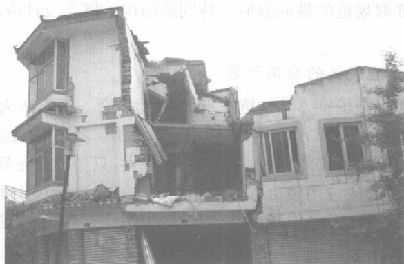
图 14 抗震措施不力房屋破坏情况
