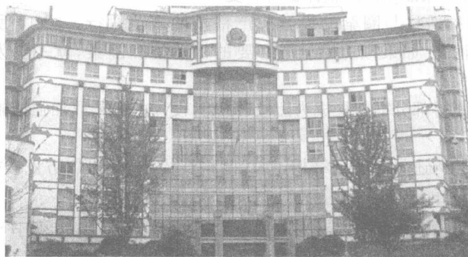
图 12 长宽比大的建筑物墙角裂缝
