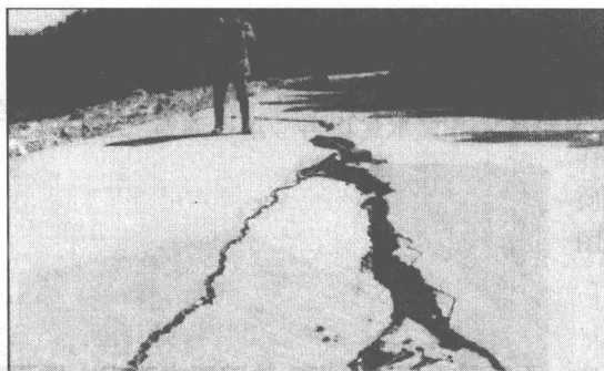
图 1-5 丽江地震中柏油路面震裂
