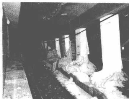
图 1-15 地下柱破坏导致路面下陷
