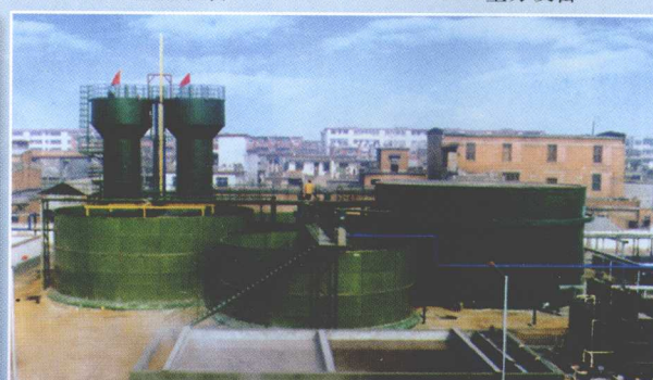
公司承建的南阳普康集团第二制药厂 1000m 3 /d高浓度庆大霉素废水处理工程
