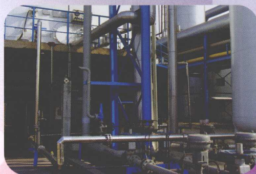
使用中的高真空低温绝热管道
