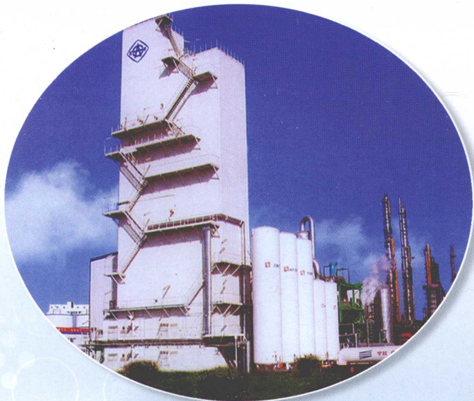
安装在山东华鲁恒升有限公司的 40000m 3 /h空分设备
