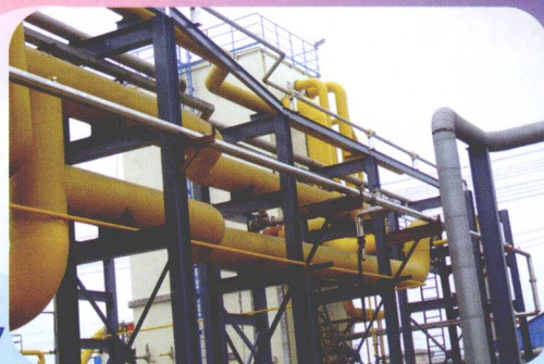
使用中的高真空低温绝热管道
