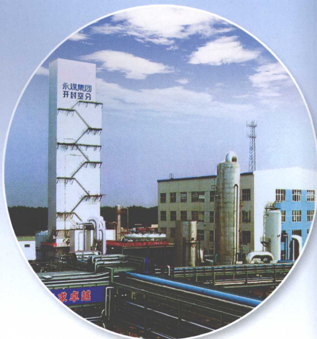
安装在永城龙宇煤化工的国产首套 53000m 3 /h特大型双泵内压缩流程空分设备
