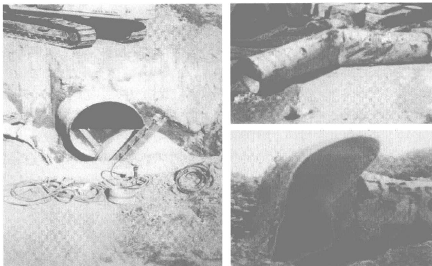
图 1-2 地震中管道系统被拉开和发生屈曲
