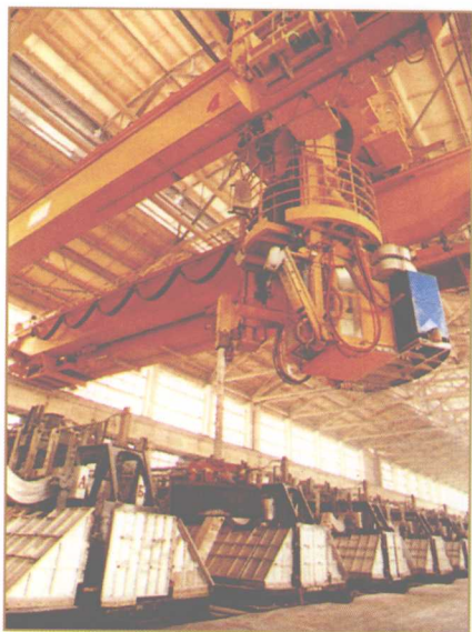
186KA中间下料大型预焙槽生产系列
