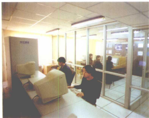
西城区丰汇园楼宇自动化管理系统
