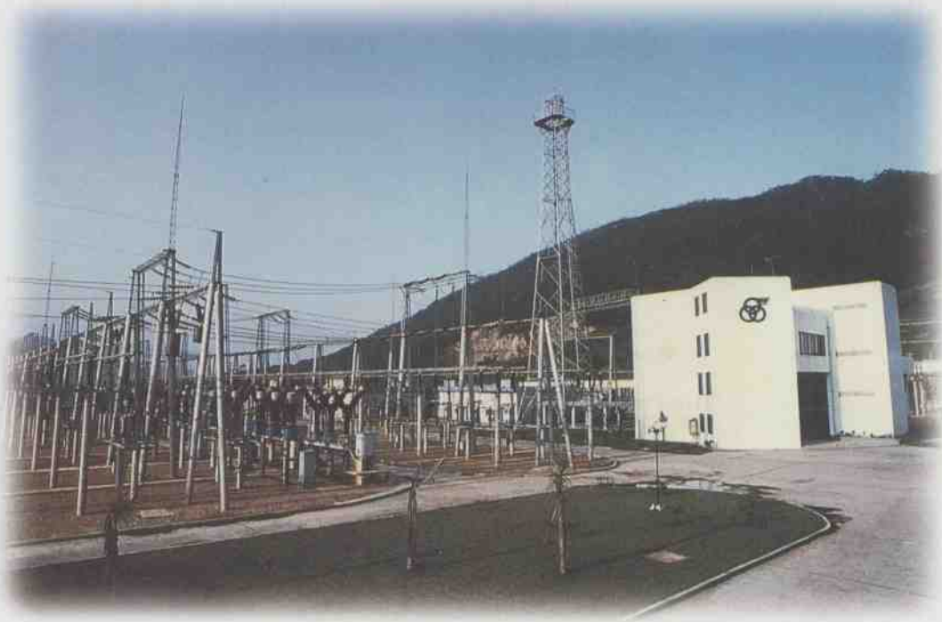
220 千伏端州变电站
