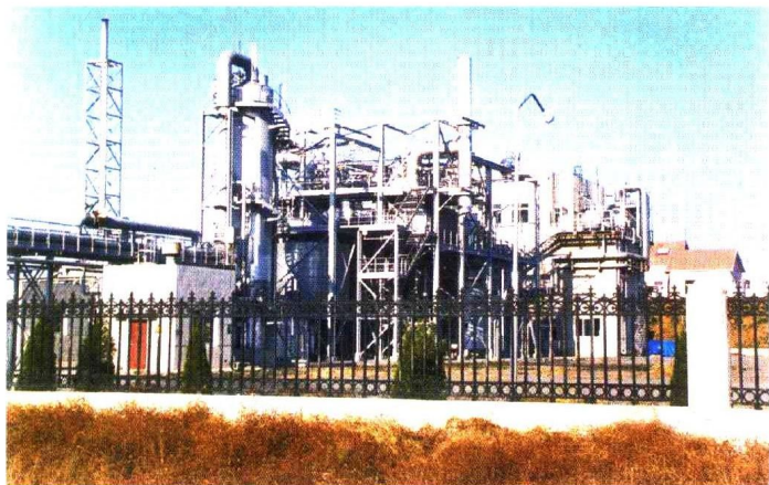
大连煤气新厂配气(设备系统)
