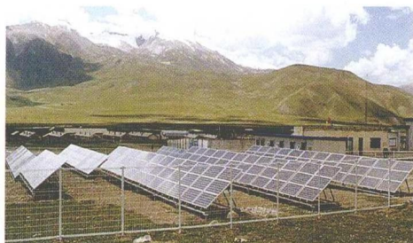
村落独立光伏电站
