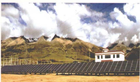
西藏羊八井100kWp高压并网光伏电站
