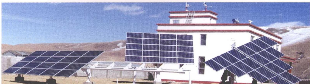
西藏羊八井 3 \times 3.3\text{kWp} 双轴、平单轴、斜单轴光伏自动跟踪发电装置
