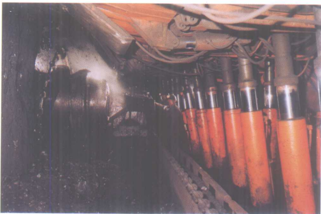
综合采煤机械化 工作面
