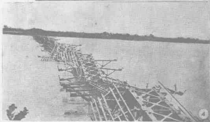
5.95公里處鋼梁橋破壞情形
