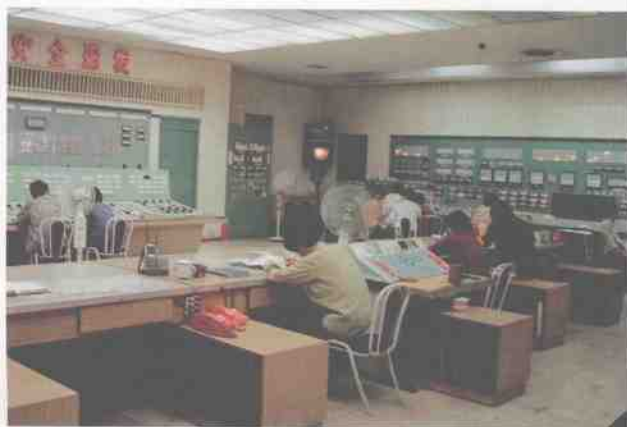
37 清镇发电厂的集控室
