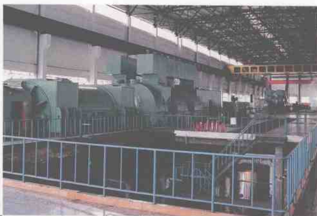
36 清镇发电厂20万千瓦机组
