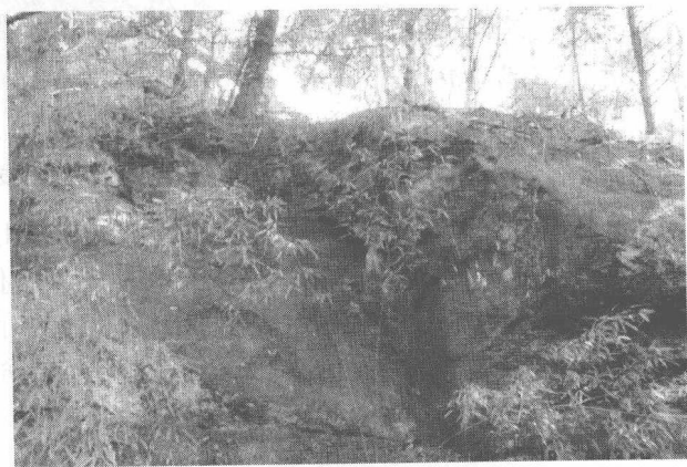
图 1.6 龙游县凤凰山未开发旅游的 20 号洞南洞口边坡的块体塌方
