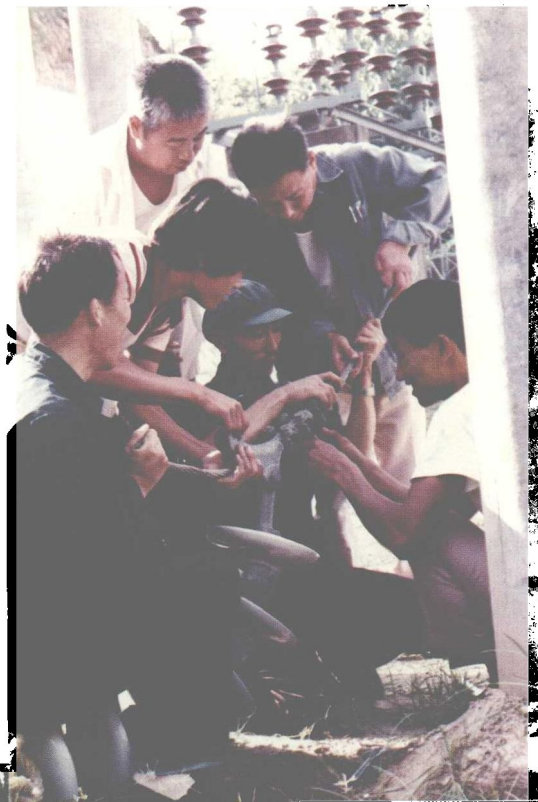
1984年10月参加夹马口泵站 高压电气检修（后排左）
