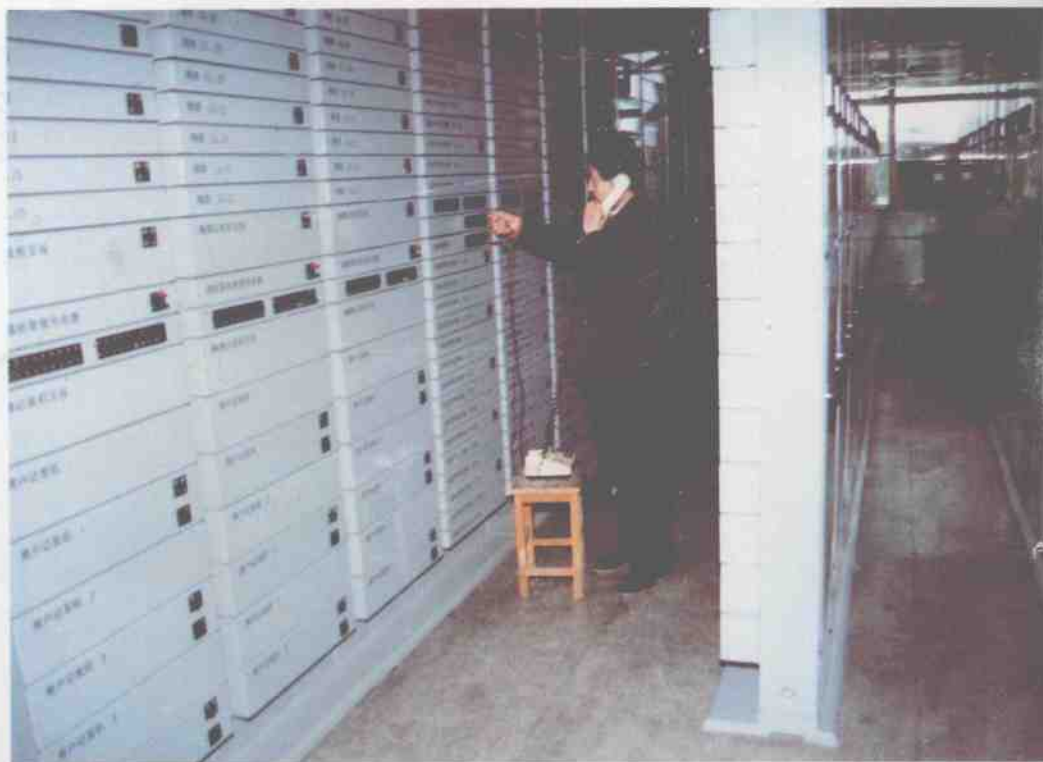
邮电局自动电话交换机房
