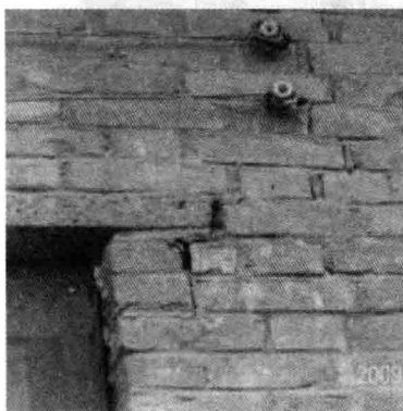
图 1-11 窗上角处斜裂缝
