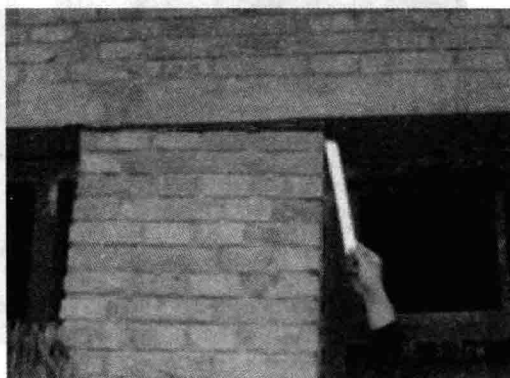
图 1-12 门过梁与墙体脱离
