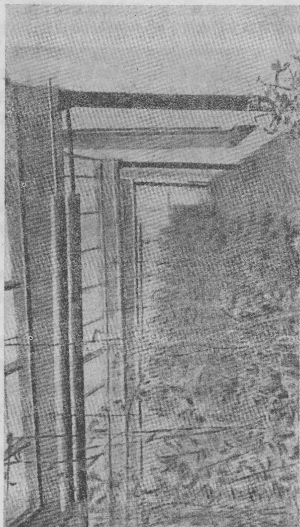
圖 4 蒸氣引入管從總管進入溫室上部採暖管(溫室北面)如照片。經過 1.5 吋的支管進到粗一些的 3 吋管。這個便是溫室的主要採暖器具。
