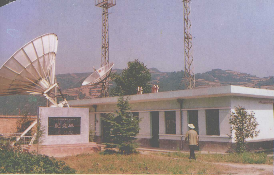
双石铺电视卫星地面接收站
