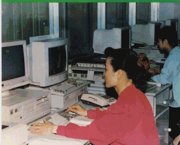
县城程控电话机房
