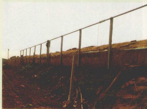
图1-17 温室后墙外埋水泥柱用于安放卷帘机
