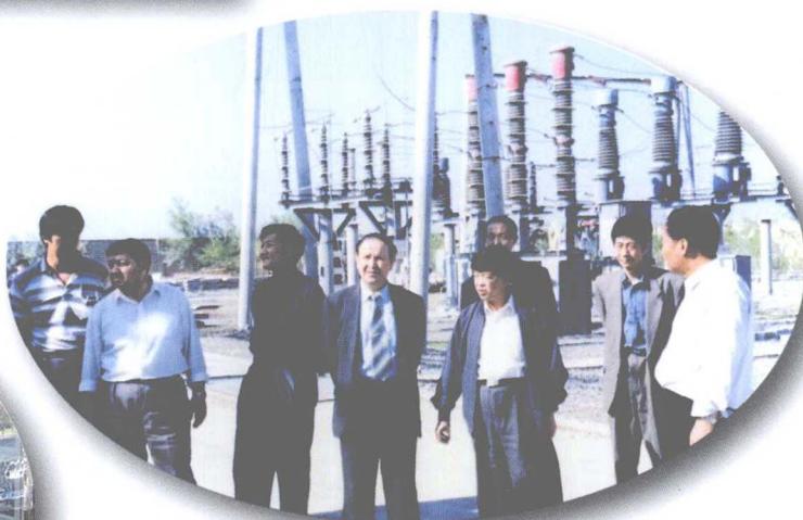
新疆电力公司党组书记买买提艾明·沙比提(左四)、副总经理孙寿年(右三)在博乐 110 千伏变电站调研
