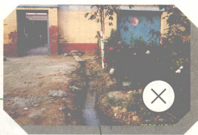
建设污水处理系统
