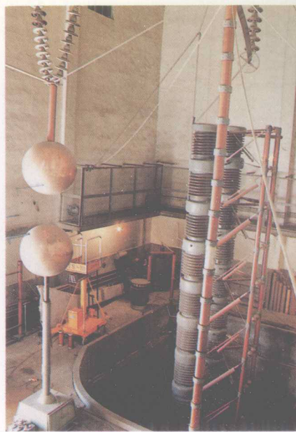
青海电力试验研究所自行设计 安装的 220 万伏冲击电压发生器
