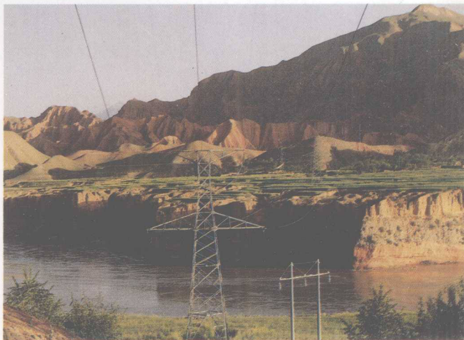
横跨黄河的 110 千伏尕让 ——李家峡线路
