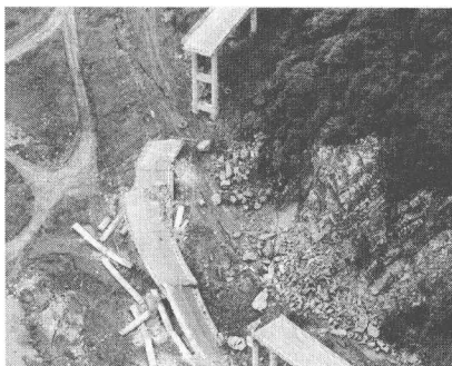
图 1.11 汶川地震引起的公路桥梁破坏
