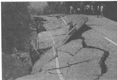
图 1.8 汶川地震的道路裂缝破坏
