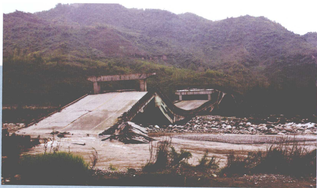
躺下的桥——彭州小鱼洞大桥毁于地震。
