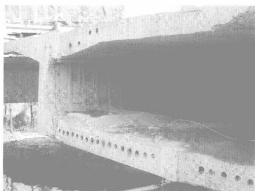
图 1-7 某桥拆除后发现几乎没灌浆
